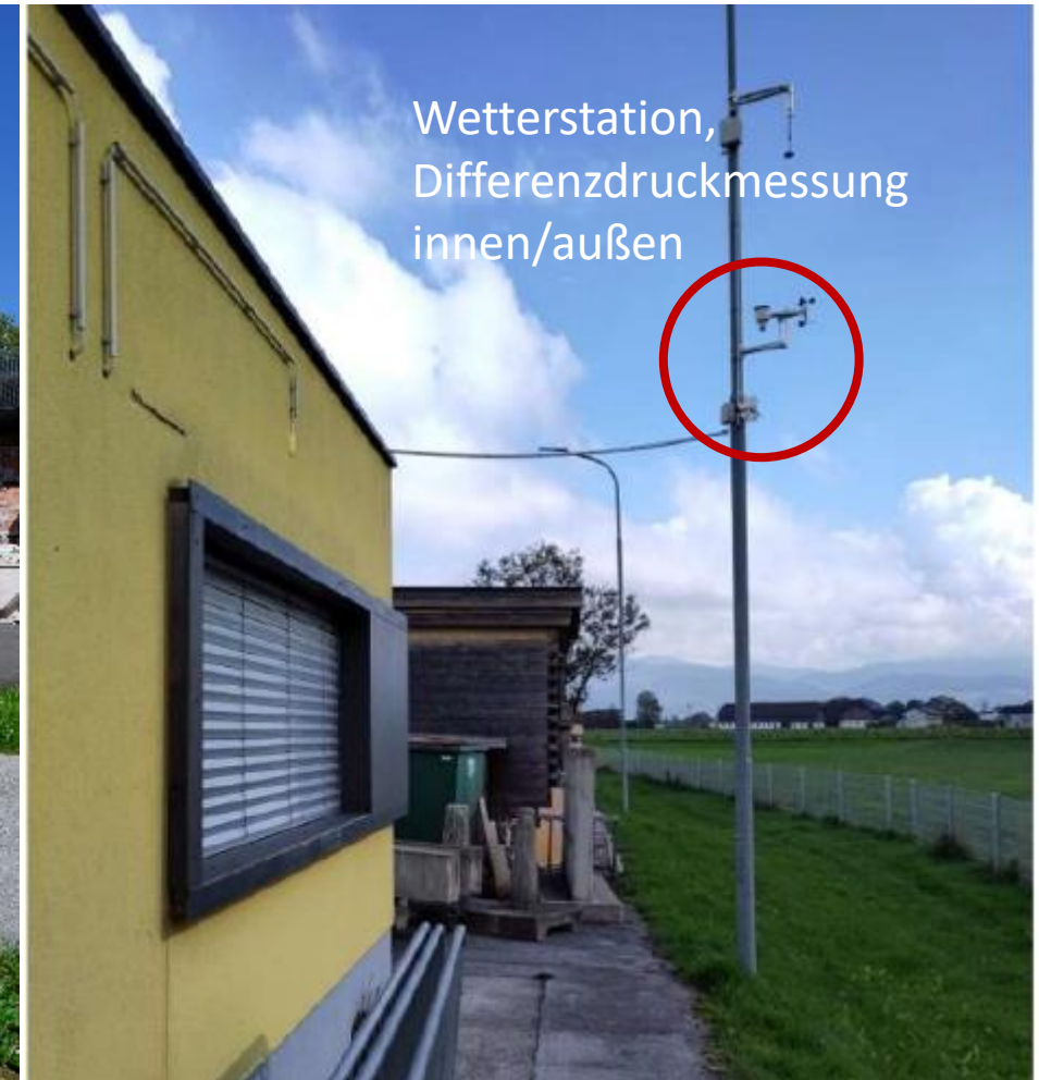
nachgerüstete Wetterstation am Leuchtenmast
